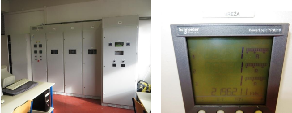
Slika 3.17. Izmjenjivači (lijevo) i ekran na izmjenjivaču (desno)
