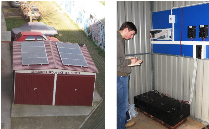
Slika 3.12. Garaža (punionica) Srednje škole Vice Vlatkovića izvana (lijevo) i iznutra (desno). Unutra se vide sastavni dijelovi autonomnog sustava garaže: akumulatori i regulator punjenja
