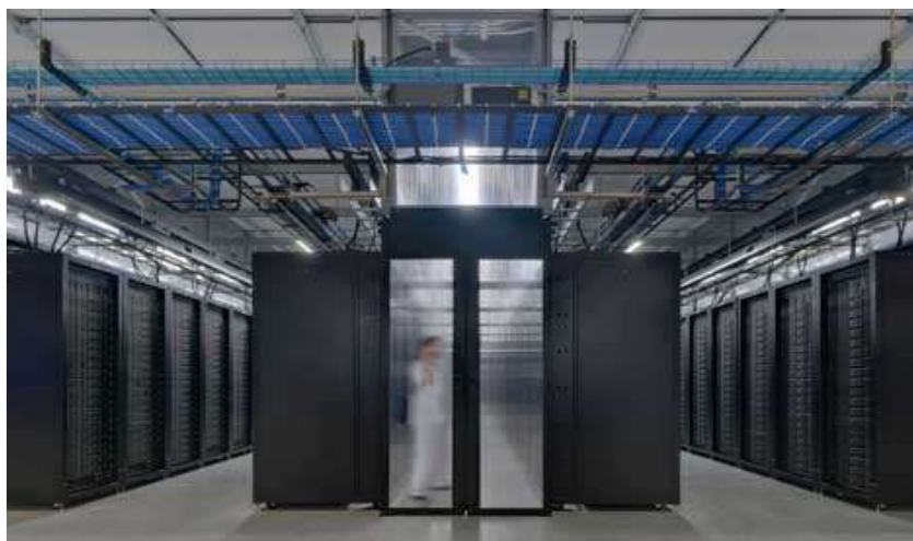
SL.8. Serverska soba
